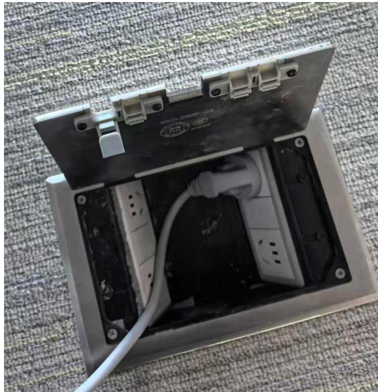
地插盖板未闭合 日常应保持闭合，以防绊倒
