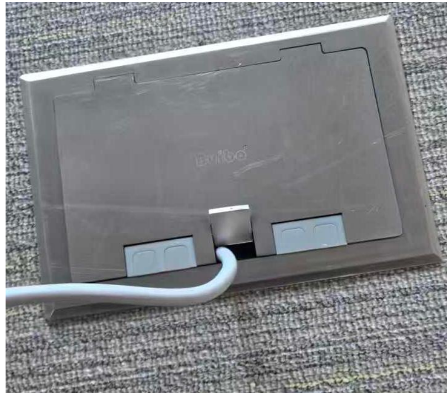
电源线出线位置错误 电源线应从预留出线孔穿出，保护电源线
